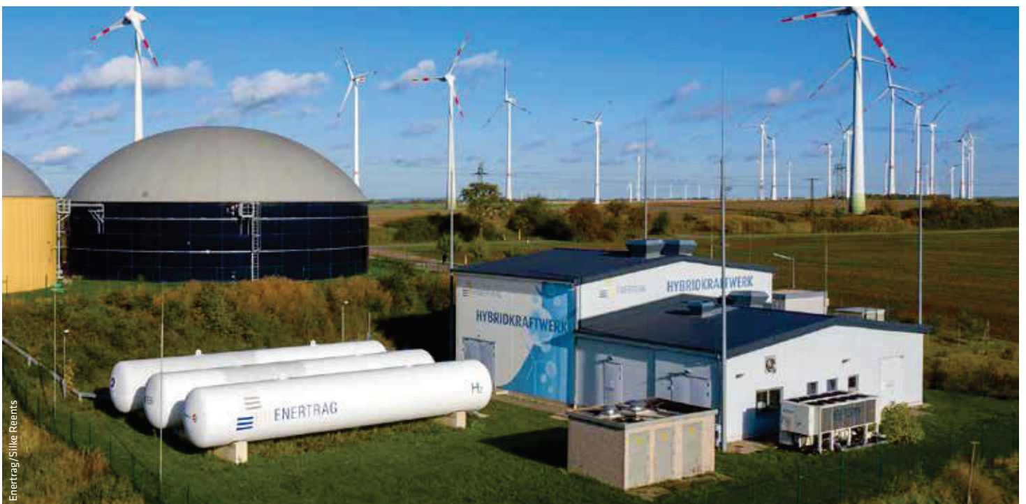
Dass Wasserstoff aus Windstromelektrolyse technisch längst funktioniert, beweist seit zehn Jahren das „Hybridkraftwerk Prenzlau“ von Enertrag mit einem 500-kW-Elektrolyseur, einer Tonne Wasserstoff-Speicherkapazität und zwei Blockheizkraftwerken zur Stromerzeugung aus dem gespeicherten Wasserstoff.
